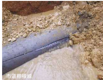
塩ビ管の破損状況(疲労破壊)
